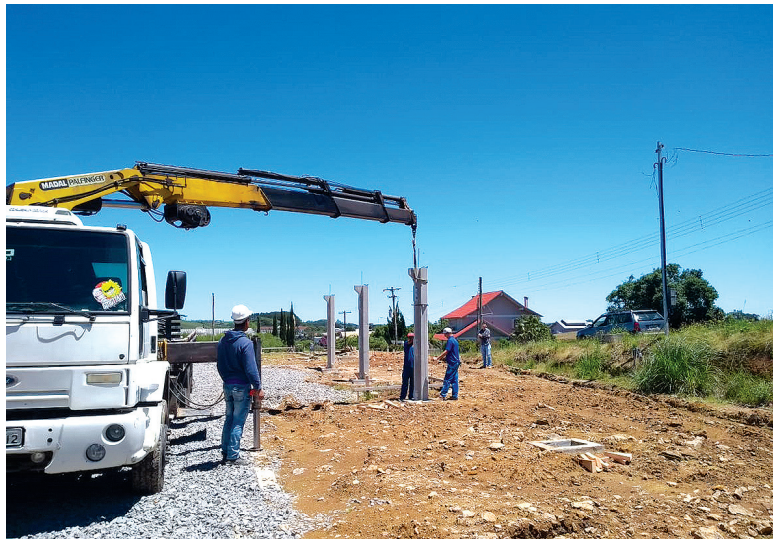
A parte estrutural da obra, idealizada em concreto pré-moldado, com peças encaixáveis de concreto reduziu o tempo de construção em seis meses
