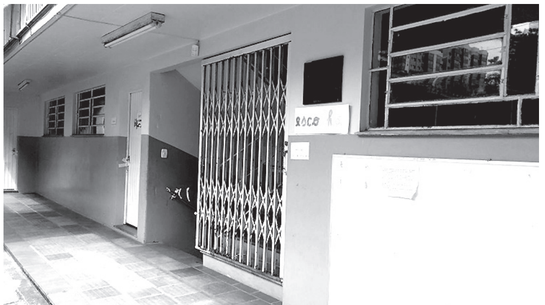
Prédio interditado tem 7 salas de aula, cozinha, refeitório e laboratório de informática
