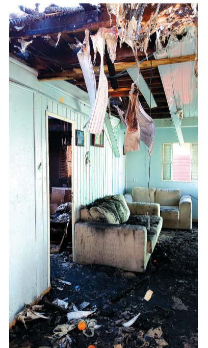
Teto da casa de Lavandoski foi perdido
